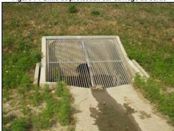
Figure 7 : Grille de protection sur ouvrage de sortie
